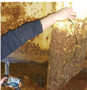
Mesures d'épaisseur dans le quai du port.
